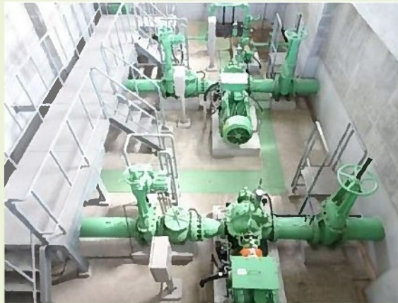
かんがい排水事業の揚水機場
