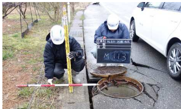
現地での被災状況調査（石川県輪島市）
