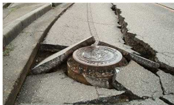
管路施設被災状況（七尾市）
