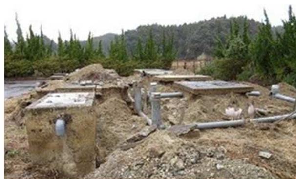
処理施設被災状況（七尾市）
