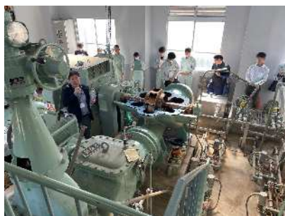
【揚水機場の見学】
