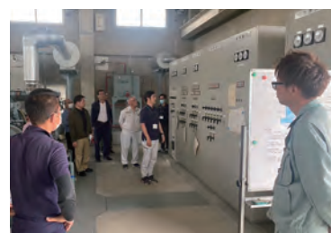
三日月排水機場
